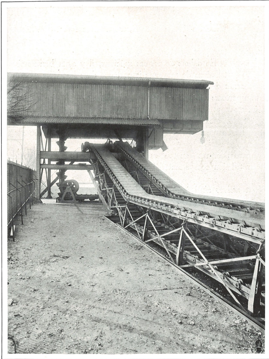
Fig. 27 — SOCIÉTÉ D'ÉLECTRICITÉ DE PARIS Installation à l'usine de Saint-Denis (Seine), d'un système complet BABCOCK & WILCOX de déchargement, transport, emmagasinement et distribution automatiques du charbon (Vue du transporteur à tablier métallique et du convoyeur à godets)
